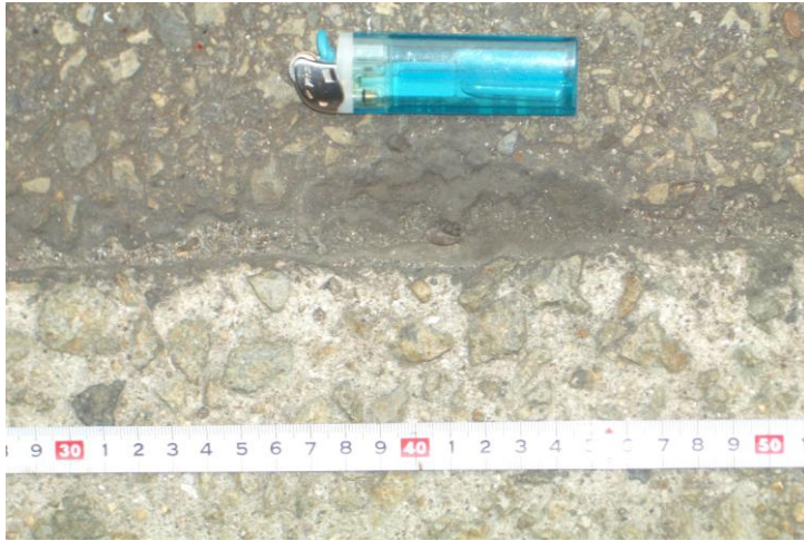
補修前クラック
